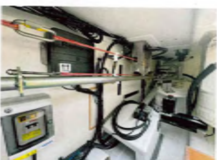
Saubere Installationen. Die Steuerung ist durch die Achterpöck perfekt zugänglich.
