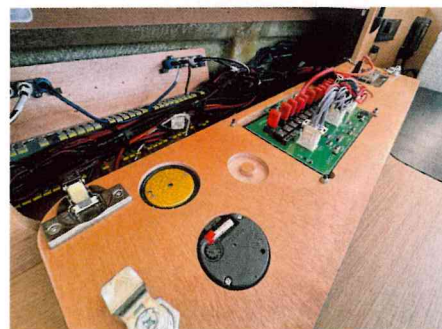
Geht besser. Unschöne und unübersichtliche Verkabelung hinter dem Elektropaneel.
